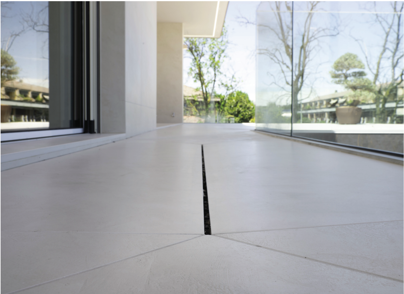
Scarico lineare pendenziato in pavimentazione custom in Dekton Nacre
